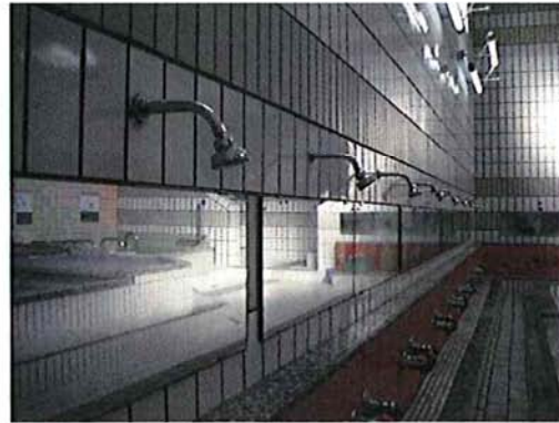
シャワー取付状況写真
